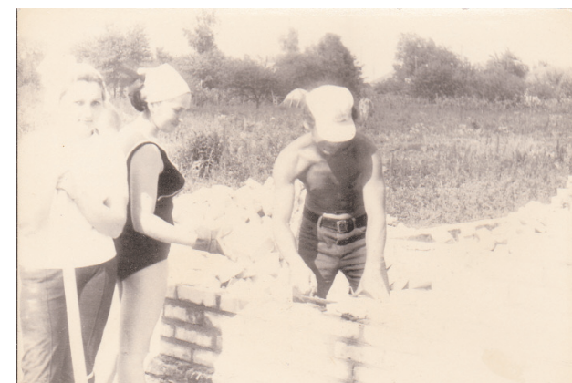
Київська обл. Броварський р-н, с. Семиполки. Д. Омельченко на будівництві житла для працівників місцевого радгоспу (1975 р.)
